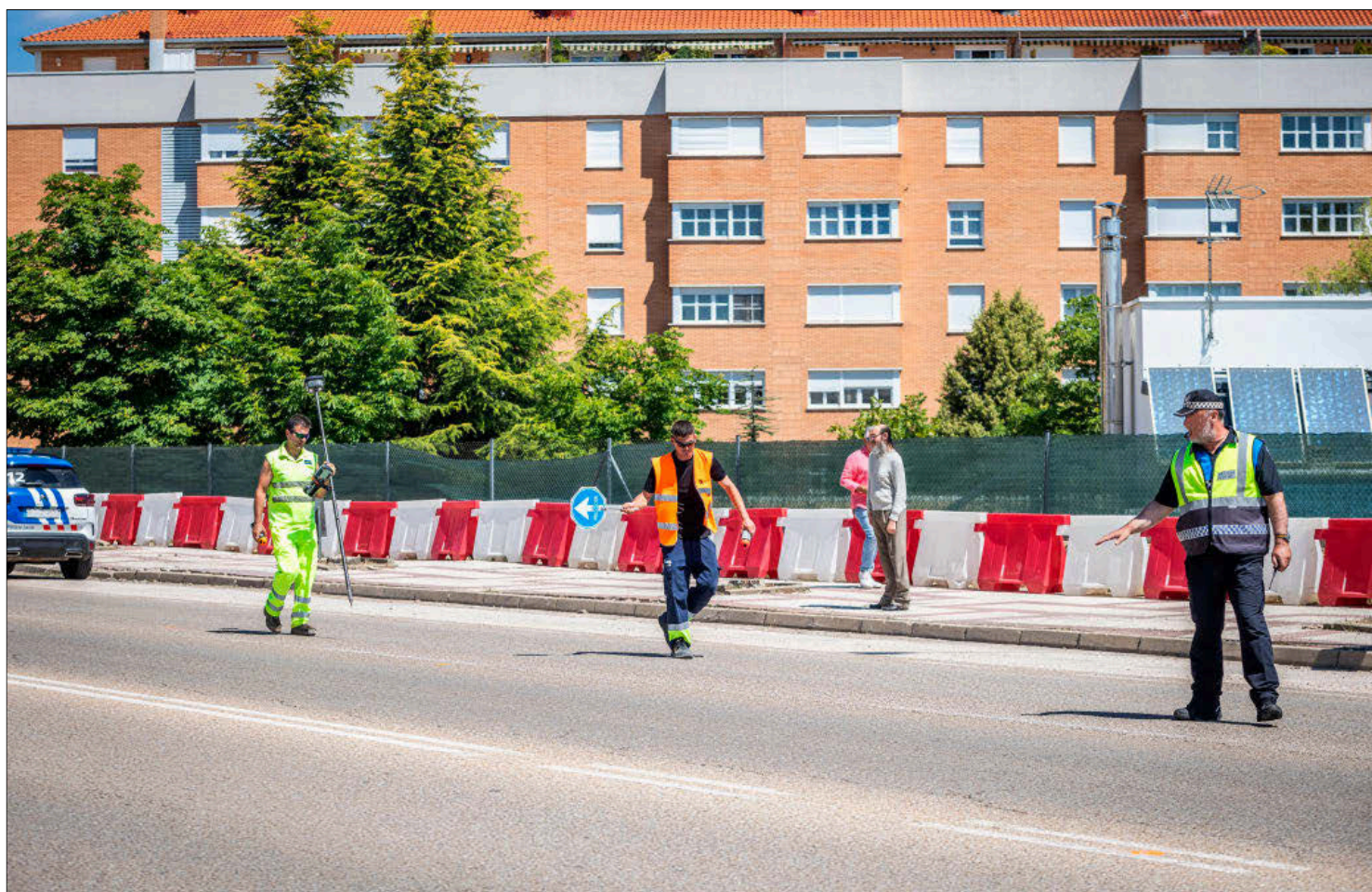
Últimas labores preparatorias antes del cierre definitivo del túnel de Eduardo Saavedra. MONTESEGUROFOTO
